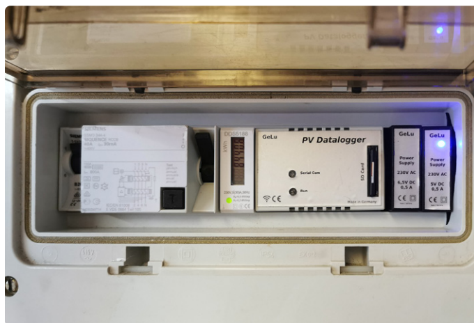
Figuur 1. De energielogger met meter en voedingseenheid, geïnstalleerd in een kleine plastic verdeelkast.
