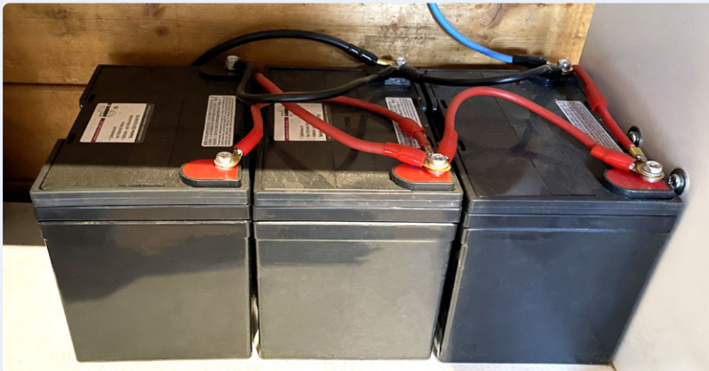
Figuur 3. Drie 12 V-lood/gelaccu's van elk 36 Ah zijn parallel geschakeld om als energieopslag in de schuur van Klaus te fungeren.
