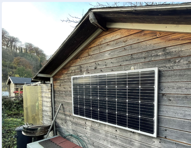
Figuur 2. Het 12V-zonnepaneel is verticaal tegen de wand gemonteerd. Het heeft een vermogen van 180 Wp.
