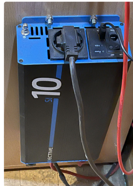
Figuur 6. Deze 1kW-omvormer van Ective is in de loop van de tijd zeer stabiel en betrouwbaar gebleken.
