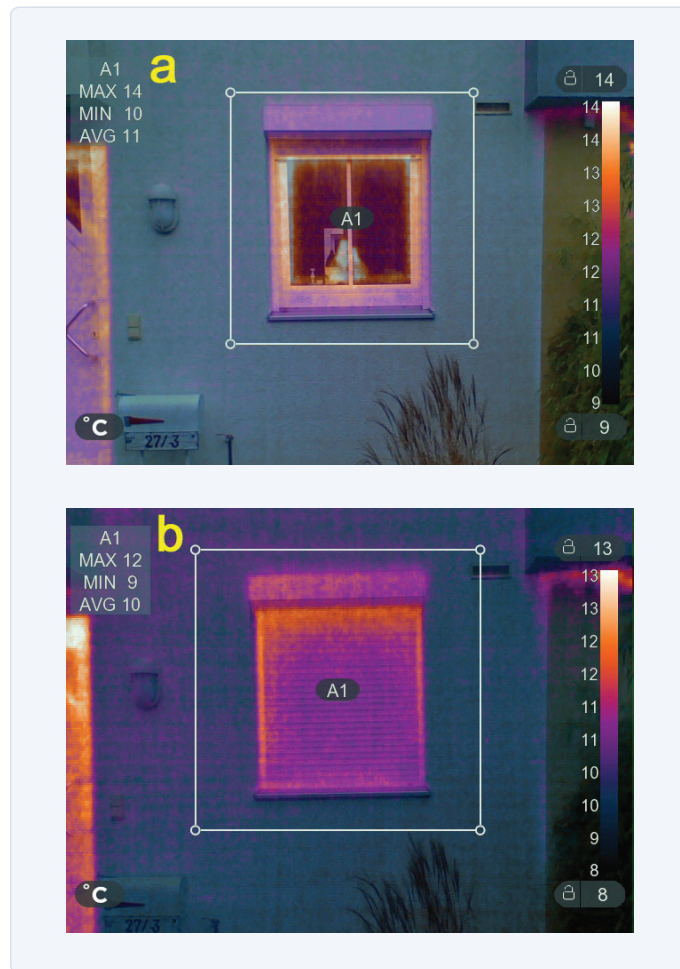
Figuur 5. Het is koud buiten, met het rolluik omhoog (a) en met het rolluik neergelaten (b).
